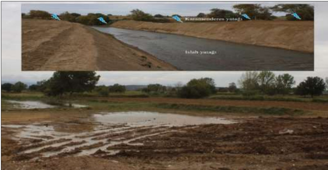
Fotoğraf 2: Yaz aylarındaki yağışlarla Ezine Ovası'nda yaşanan taşkın sonucu tarım alanlarındaki suyun drene edilmesi için Karamenderes Çayı geçici süreli ıslah yatağına yönlendirilmektedir
